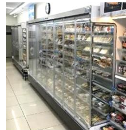
扉を設置した冷蔵ショーケース
