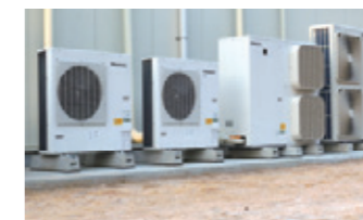
CO 2 冷媒を使用した冷凍・冷蔵システム
