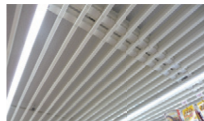
天井の放射パネルで夏季にしっかり冷却し、発生した結露水を排出することで同時に除湿
