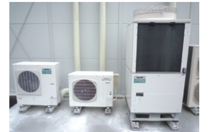
CO 2 冷媒冷凍・冷蔵システム。従来機器と比較してCO 2 排出量を半減し、店舗全体の電気使用量も12%削減することが可能
