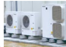
CO 2 冷媒冷凍・冷蔵システム
