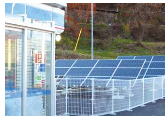
▲太陽光発電システム
