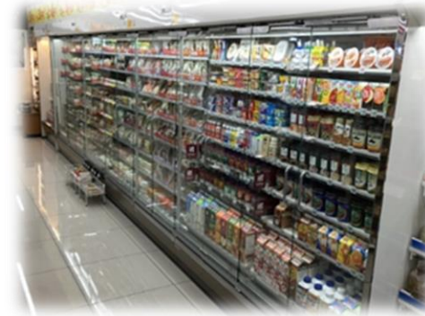
ガラスの扉を設置した冷蔵ショーケース
